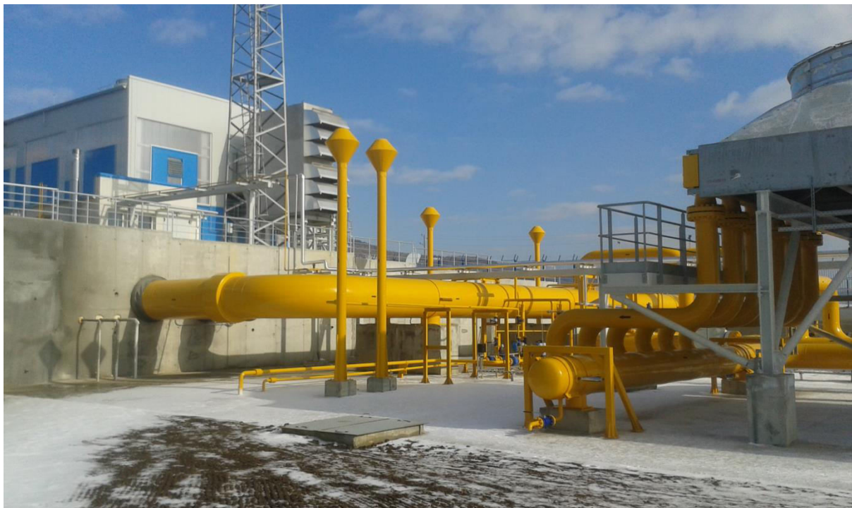
Компресорна станция „Лозенец“
