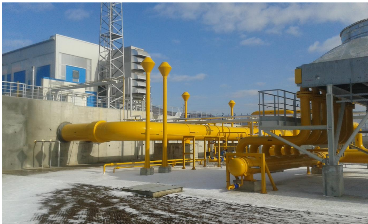
Компресорна станция „Лозенец“
