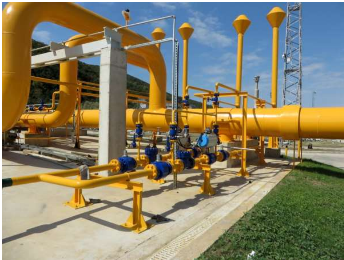
Компресорна станция „Ихтиман“
