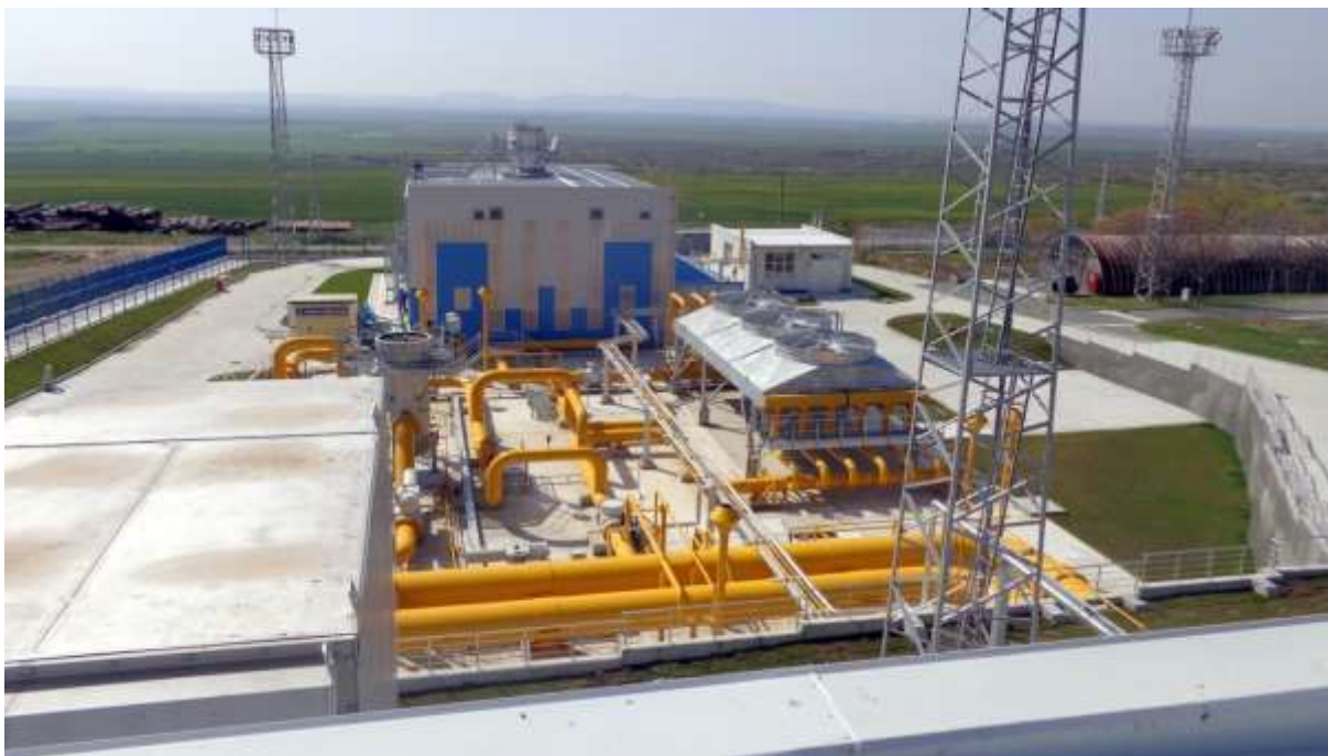
Компресорна станция „Лозенец“
